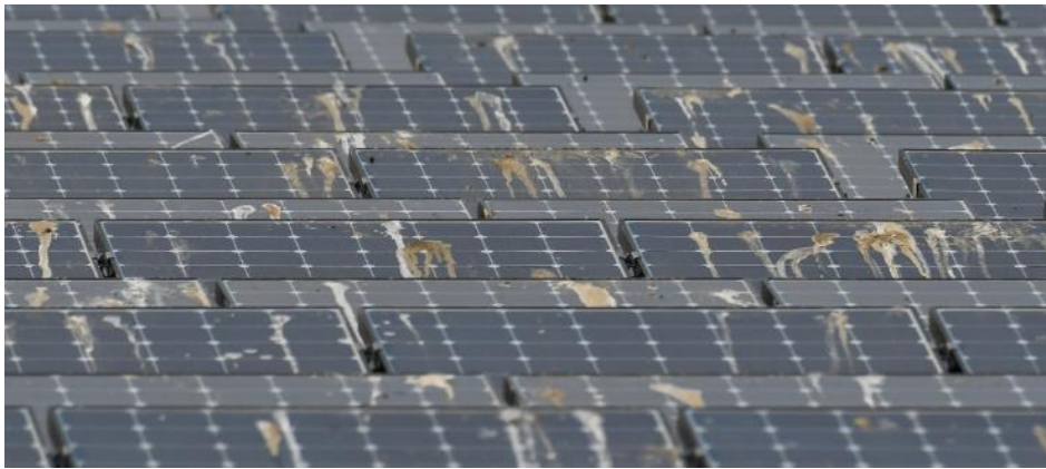
圖 2.6 - 5、光電板被鳥糞覆蓋
