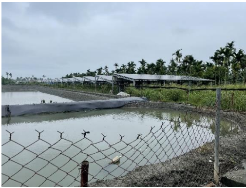
魚塭旁為光電設施
